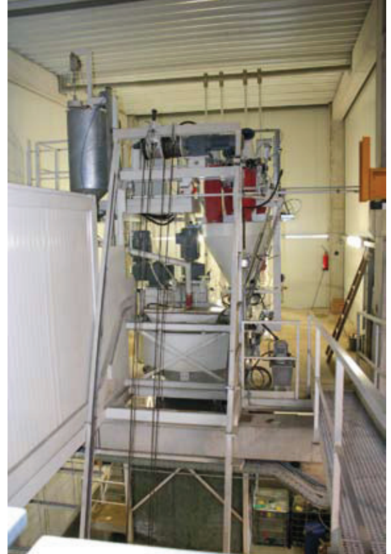
Abb. 9 Der Mischer wird über den Kippkübelaufzug mit Absturzsicherung mit den Ausgangsmaterialien gespeist.
